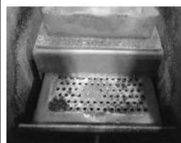
Grătar murdar și găuri înfundate
